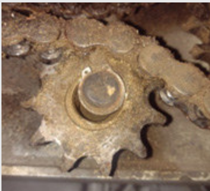
Figura 2. Bujes de Catarina de sistema de nivelación de canastilla con desgaste severo.
